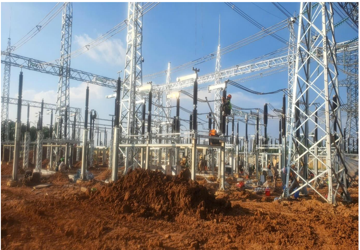
Nâng công suất TBA 500kV Việt Trì
