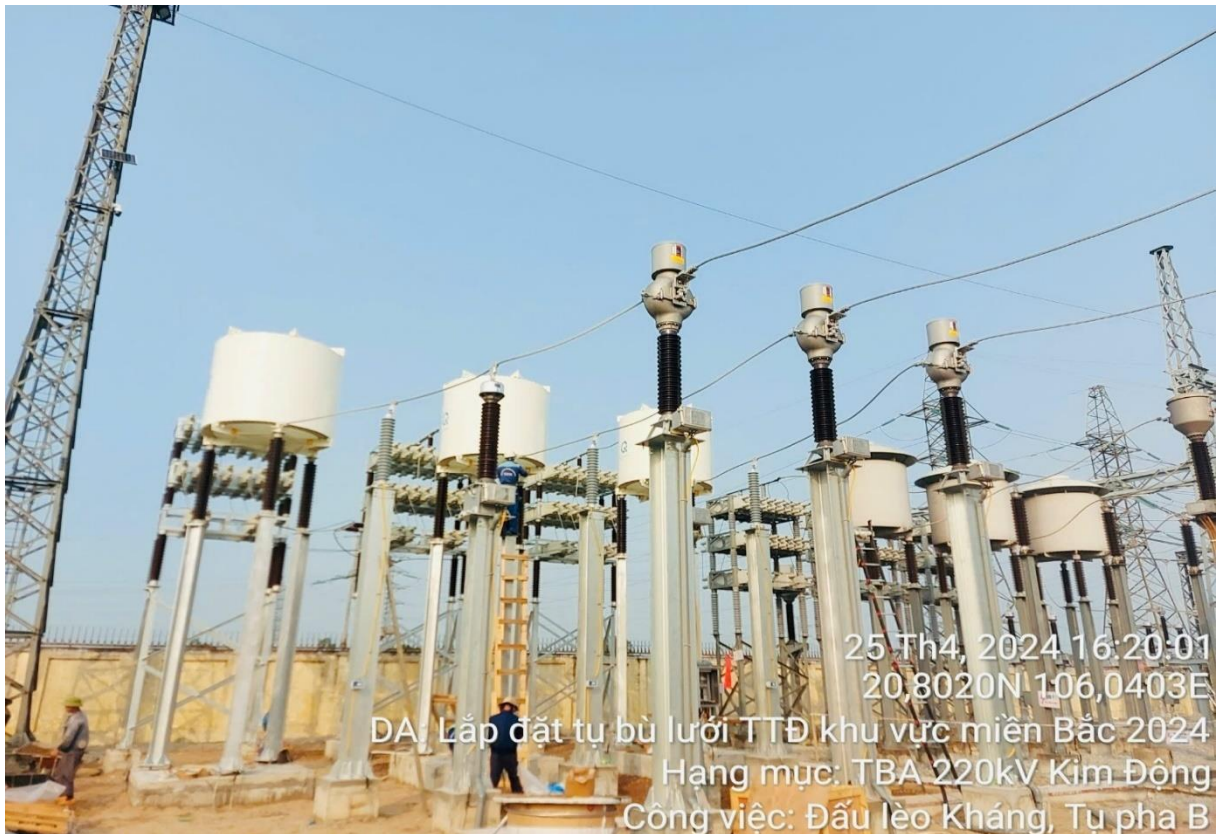
TBA 220kv Kim Động – Đấu lèo kháng, tủ pha B
