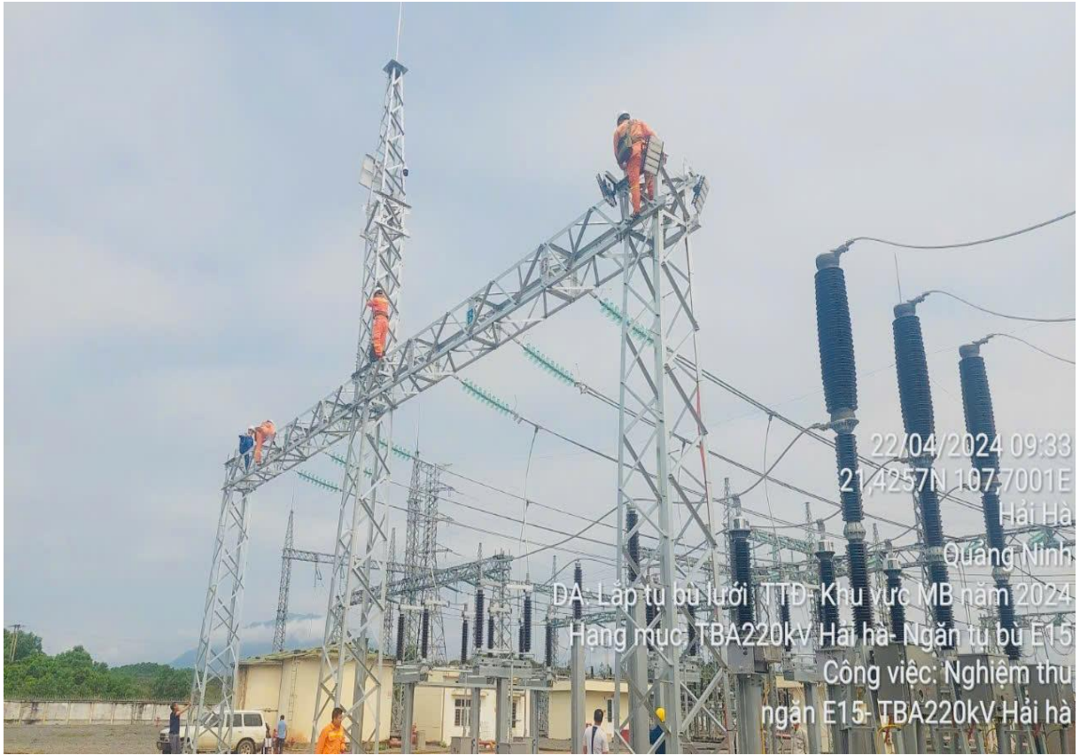
TBA 220kv Hải Hà – Nghiệm thu ngăn lộ E15
