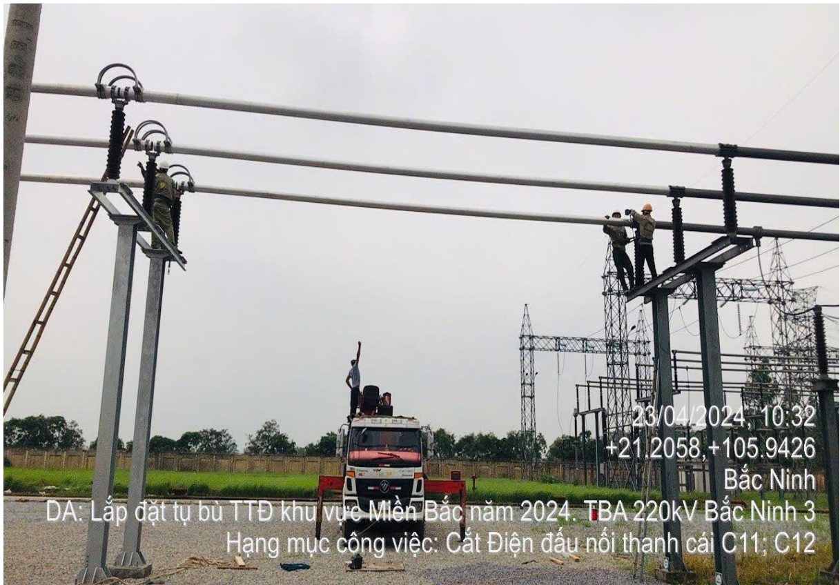
TBA 220 kv Bắc Ninh 3 – Cắt điện đầu nối thanh cái C11; C12
